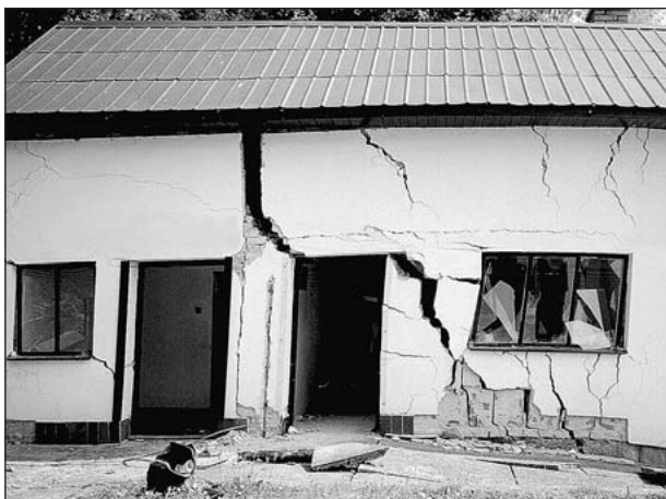
Důsledek svahové deformace sesuvu v Růžďce v roce 1997
